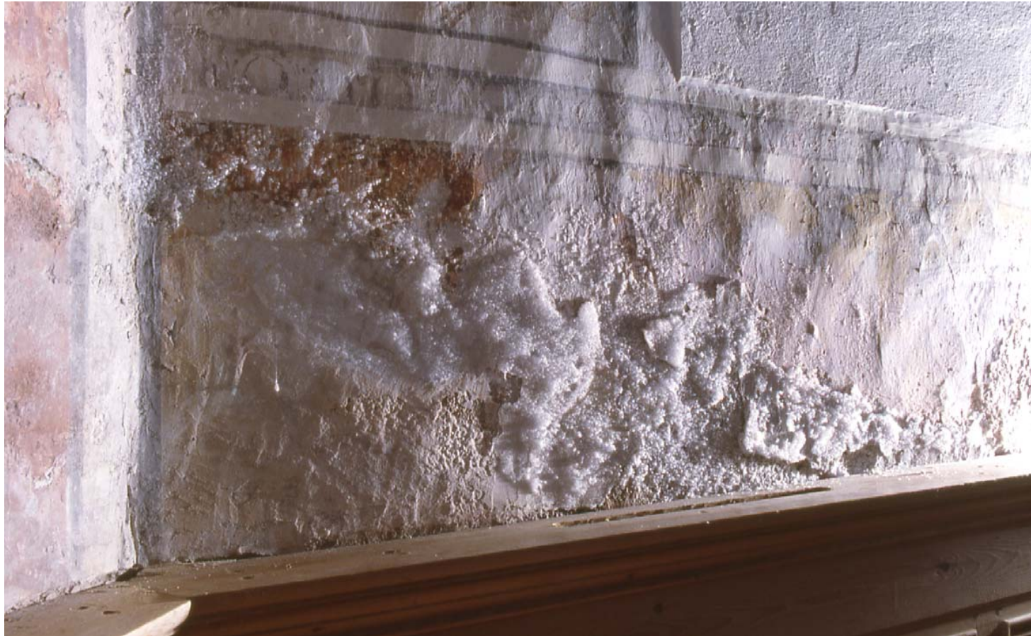
Lavin, Kirche. Salzausblühungen an der Chor-Nordostseite aus Natriumsulfat. Bildbreite ca. 1.5 m © ETHZ, Institut für Denkmalpflege, Konrad Zehnder
